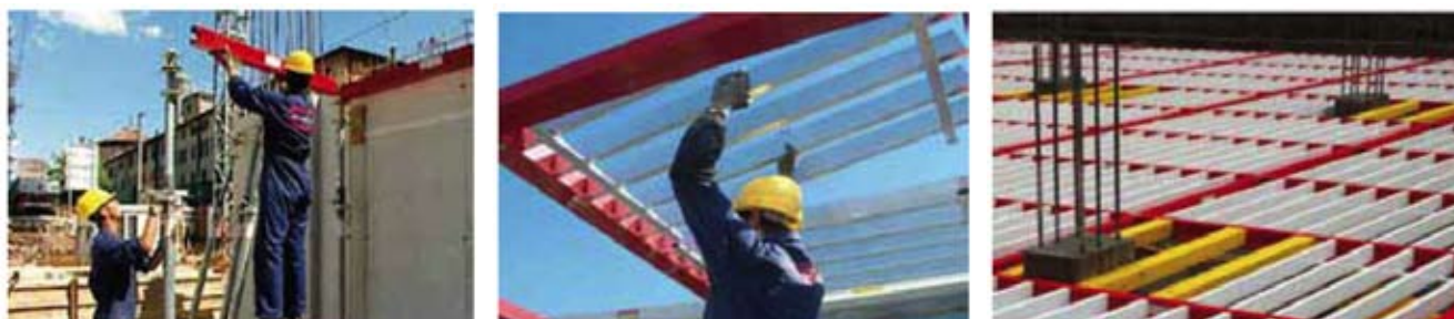
Immagine 11, 12 e 13 Utilizzo casseformi industriali (grigliato leggero) per posa travi e solai
