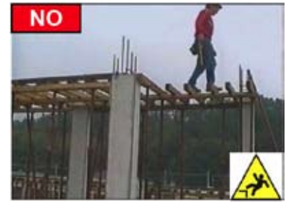
Immagine 03 Camminamento sui travetti banchinaggio trave senza protezioni
